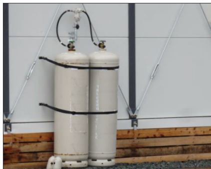
仮設住宅への LPG 供給
