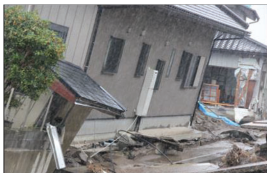
濁流により土台の傾いた住宅
