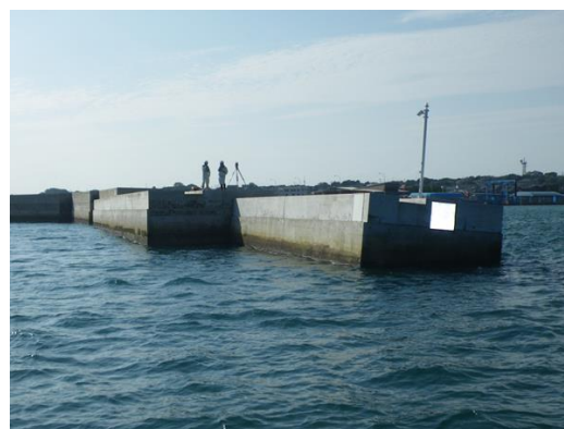
写真1 防波堤傾倒状況
