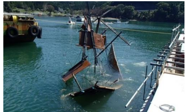
写真 5 鋼製型枠被災状況
