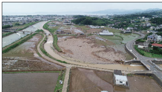
写真－2 護岸崩壊状況
