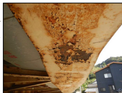
写-3 鋼部材の腐食
