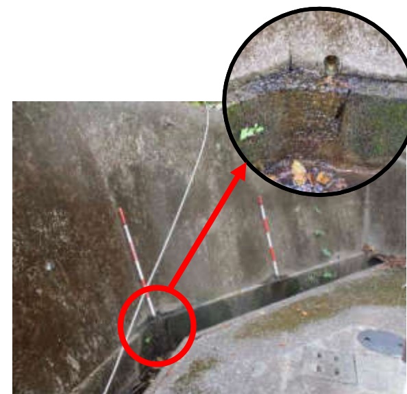
⑤水抜きからの漏水
