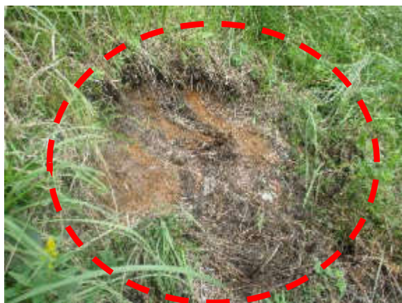
⑤堤体下流法面からの漏水
