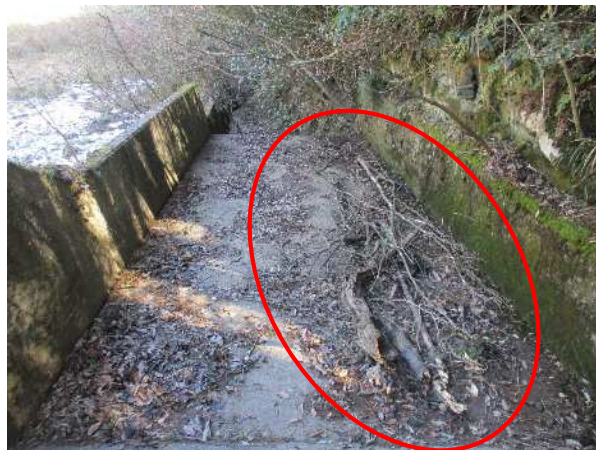
放水路内の流木の堆積
