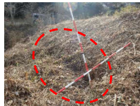
①堤体法面の亀裂
