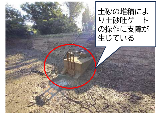
ため池堤内の土砂の堆積
