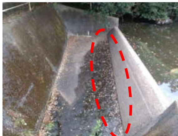
⑦越流堰底からの漏水
