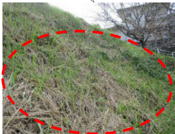
①堤体法面のはらみだし
