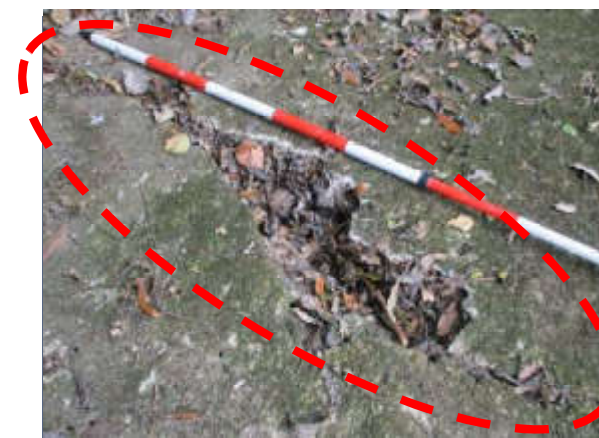
⑨水路底版の損傷
