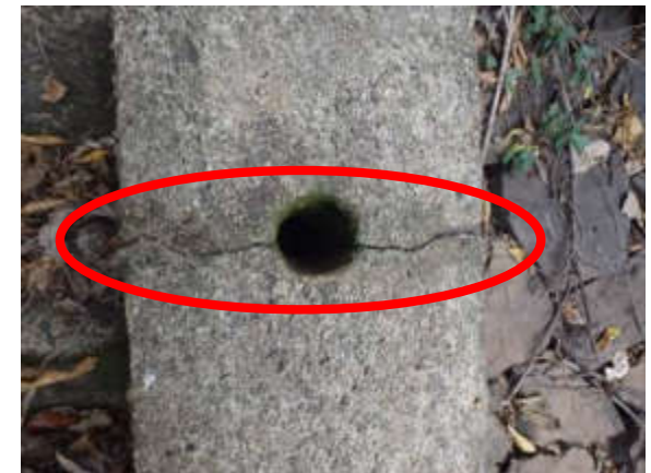
⑭斜樋の損傷
