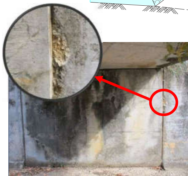
⑨水路側壁の損傷
