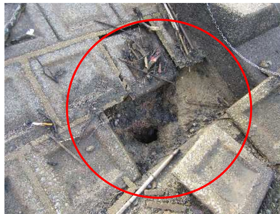
堤内側のパイピングホール
