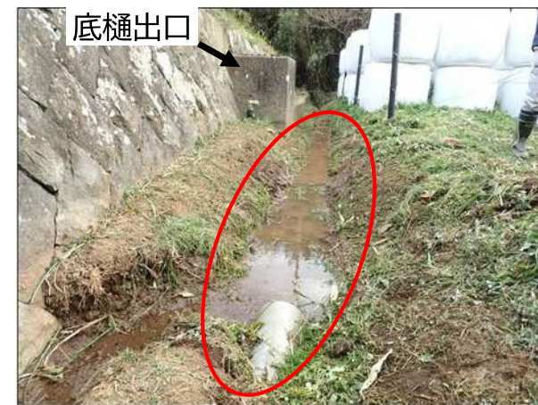
底樋出口周辺からの漏水
