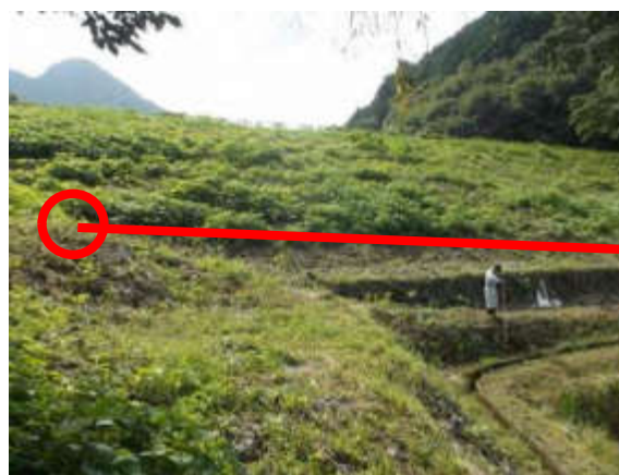
④堤体と地山境界付近からの湧水
