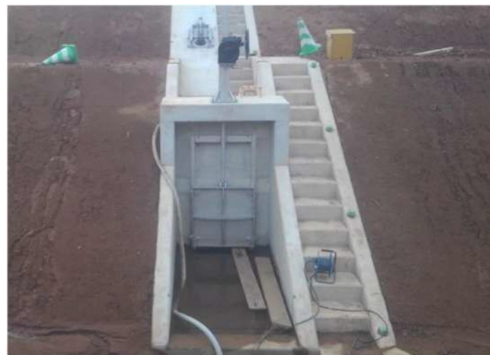
斜樋・土砂吐ゲート
