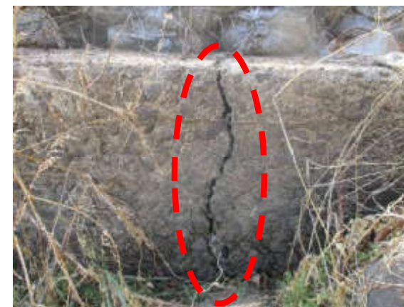
⑦水路側壁のひびわれ
