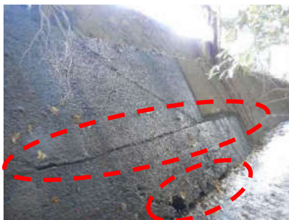
⑦ひびわれからの湧水
