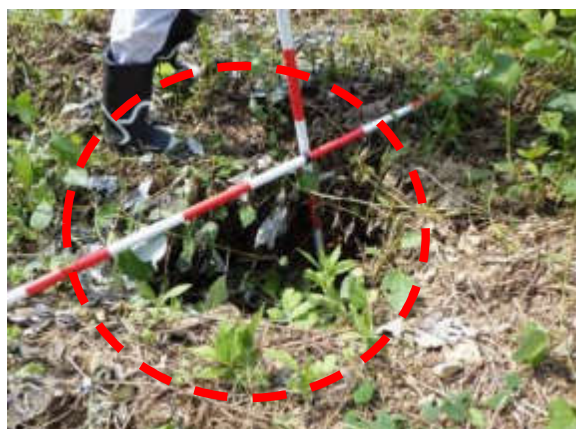
①堤体法面の陥没
