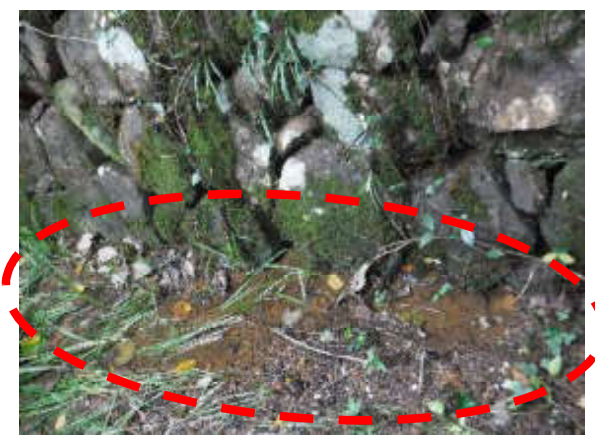
⑤腰石垣からの漏水
