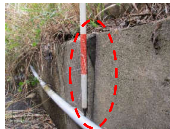
⑧水路側壁のたわみ
