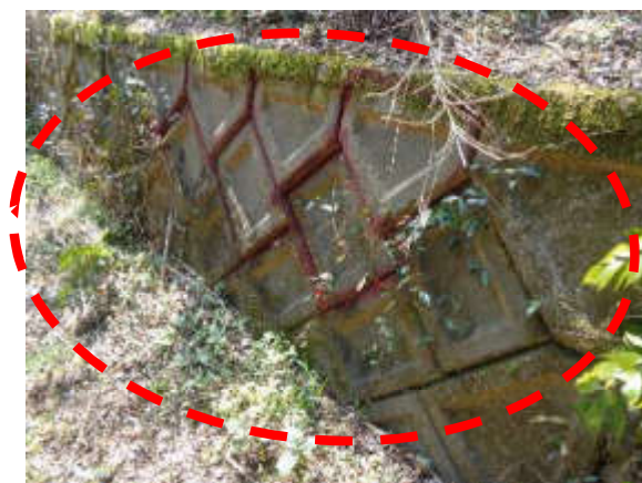
①腰石垣のはらみだし
