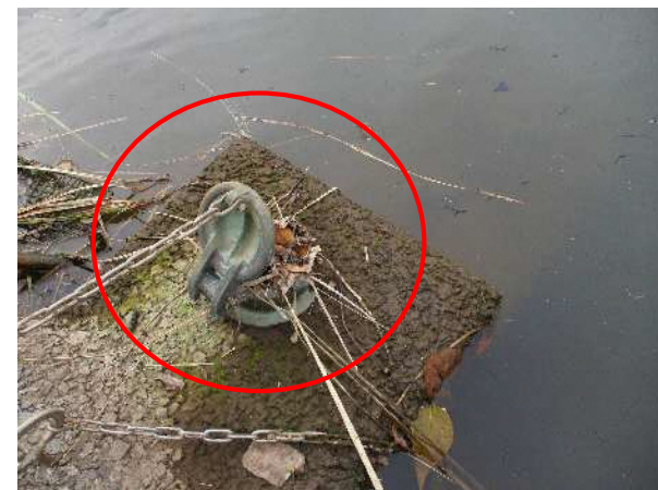
取水栓に落葉が詰まっている
