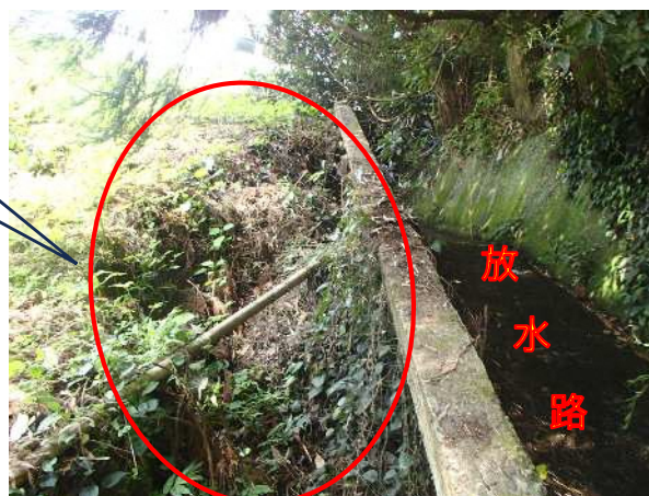
下流水路側の堤体の洗掘
