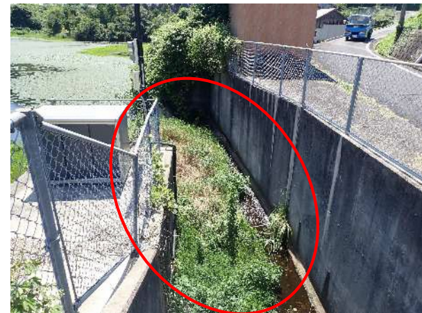
放水路内の土砂の堆積
