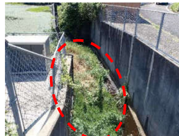
⑩洪水吐内の植物の繁茂
