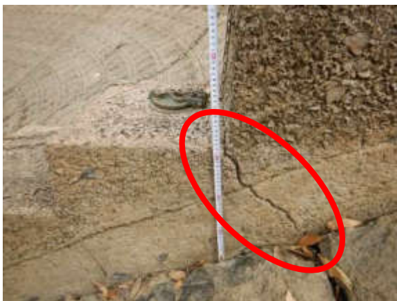
⑭斜樋の損傷
