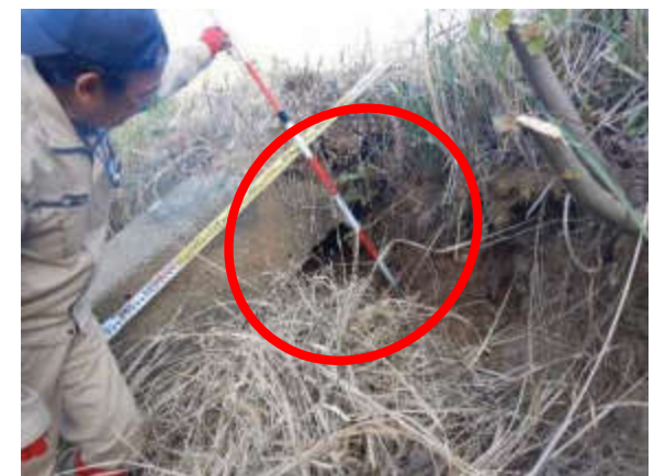
⑮斜樋と堤体境界での隙間
