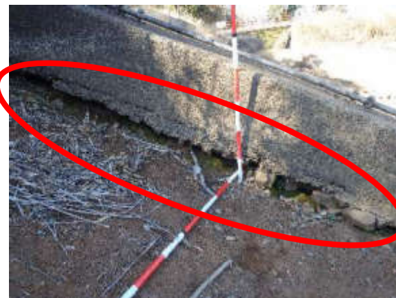
⑮斜樋と堤体境界での隙間
