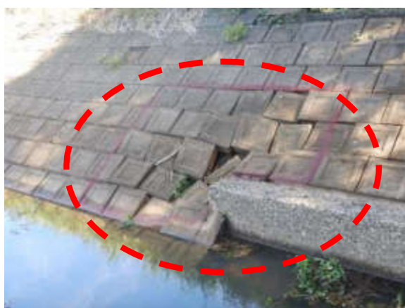
②張りブロックの損傷
