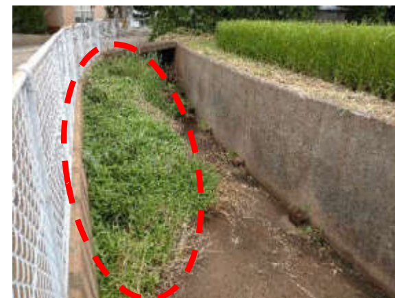
⑩下流水路の植物の繁茂
