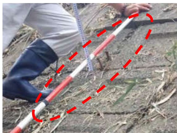
②張りブロックの陥没
