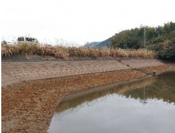
落水後の堤内法面の状況
