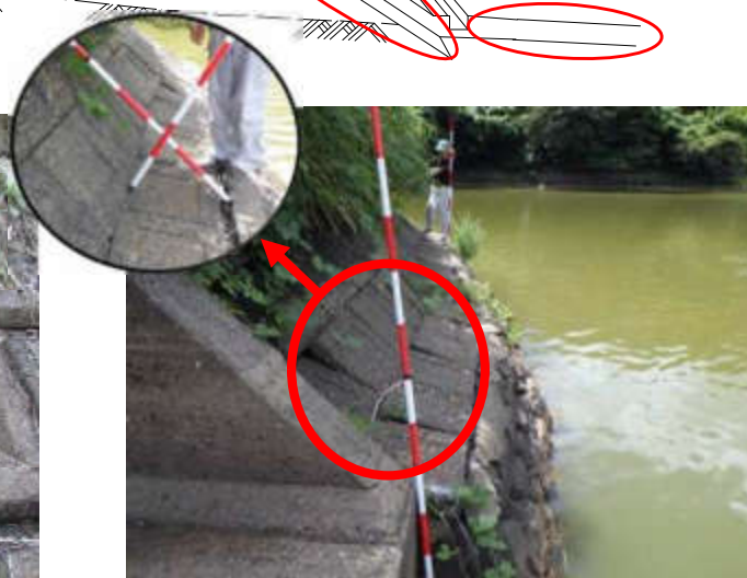
⑪土砂の流亡による陥没
