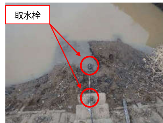
⑩取水栓周辺への土砂の堆積
