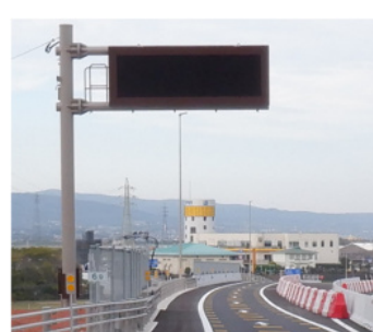
写真3 道路情報提供装置
