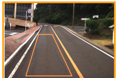
【健全度Cの状況】 一部損傷がある状態
