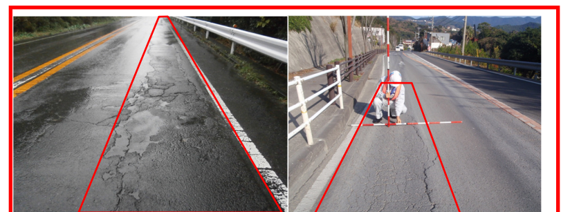
【健全度Eの状況】 損傷が著しい状態
