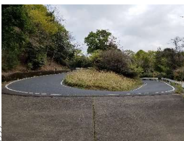
現況写真③(線形不良箇所)
