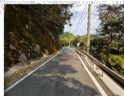
現況写真②(幅員が狭く離合困難)
