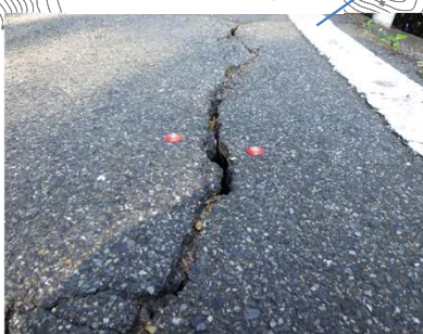
災害危険箇所写真
