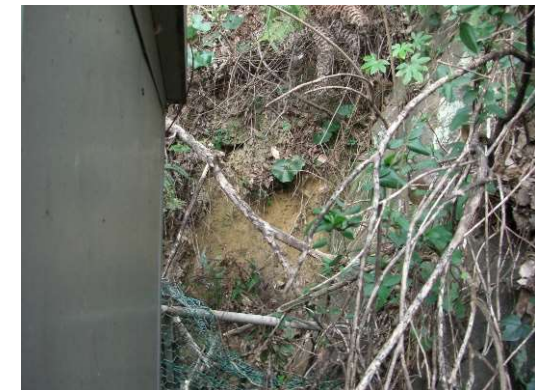
②民家裏 風化砂岩露頭状況
