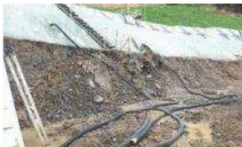
【写真】切土斜面湧水状況
