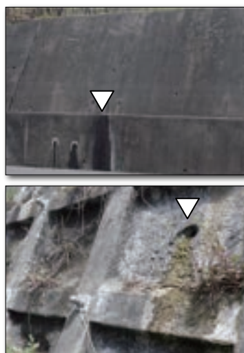
地下水の流出
