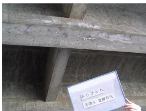
主桁-ひびわれ，漏水・遊離石灰
