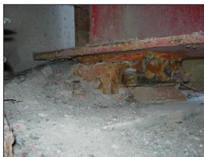
沓座-漏水・帯水，土砂詰り
