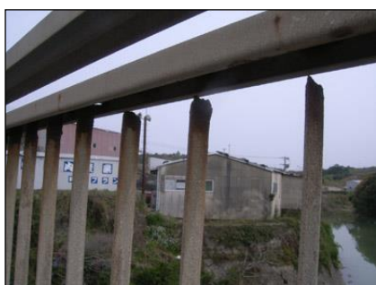
防護柵-腐食，破断
