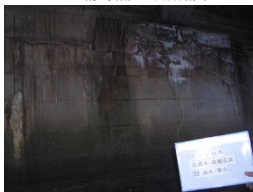
橋台-ひびわれ，漏水・遊離石灰
