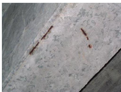
主桁-剥離・鉄筋露出
