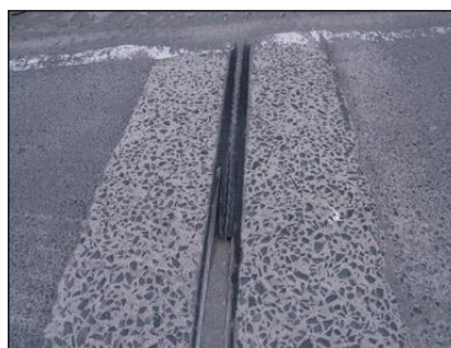
伸縮装置-変色・劣化
