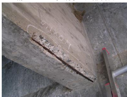
横桁-剥離・鉄筋露出
