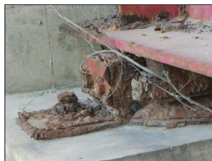
支承-腐食，機能障害
