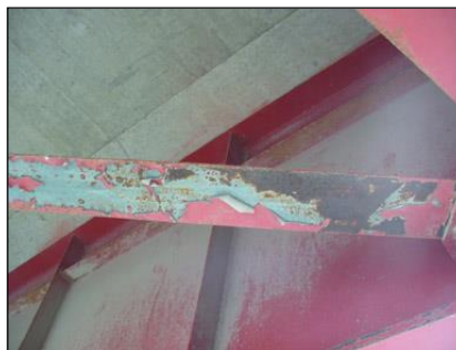
対傾構-防食機能の劣化
