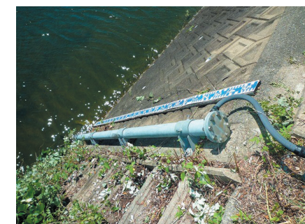
河川水位計設置状況
