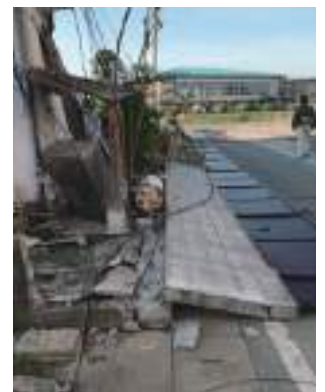
熊本地震での被災事例
