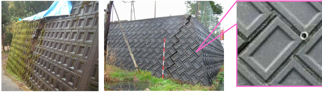
(a)水抜穴が無い前傾した擁壁 (b) 水抜穴が 20 mm と小さい事例 写 3 - 1 擁壁の水抜穴規格の不具合の事例
