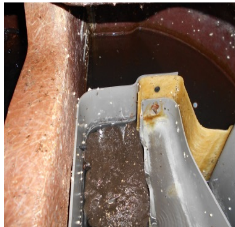
(7日後、沈殿槽にスカム浮上8/27)
