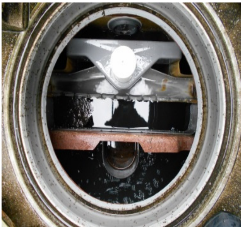
(ばっ気停止時の沈殿槽の状況8/19)
