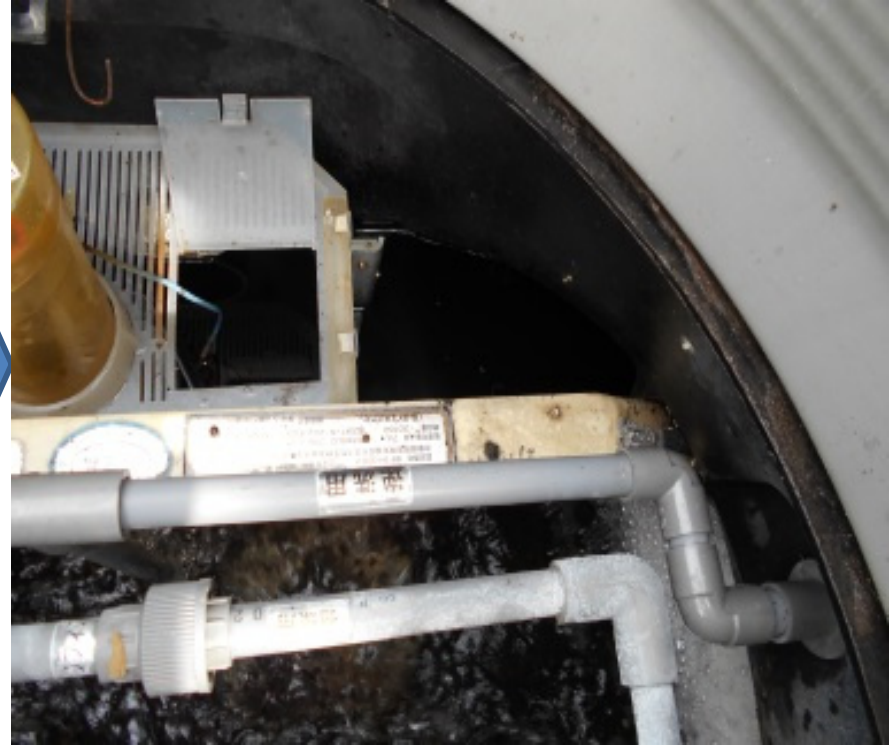
(7日後の処理水槽)
