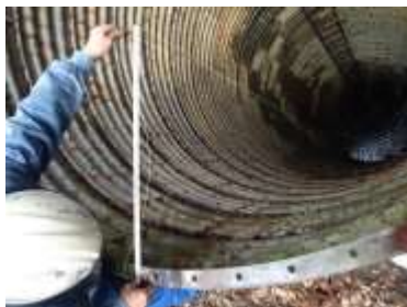
既設集水井戸の傾き
