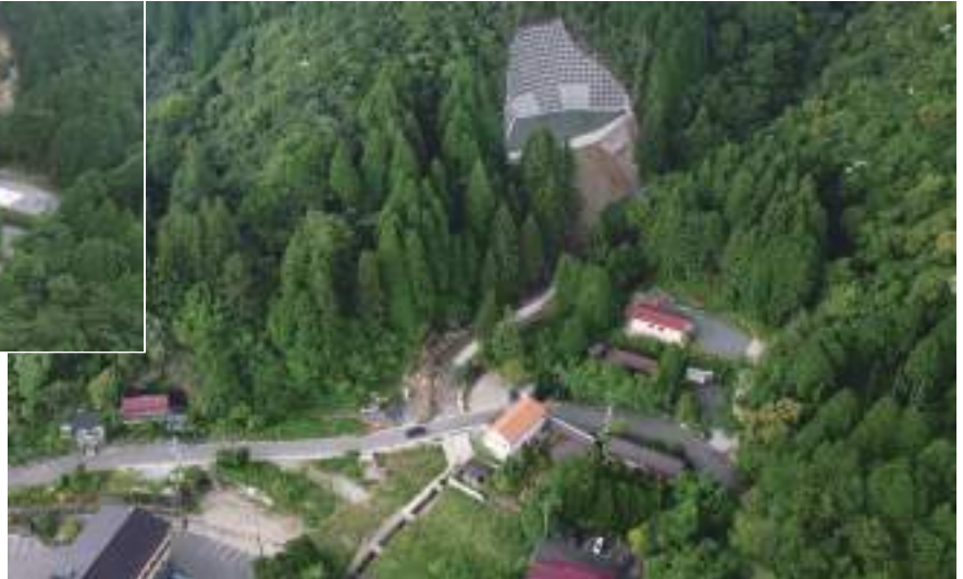
雲仙市 小浜町 小地獄地区（治山事業施工中） （令和3年8月の大雨による被災箇所）
