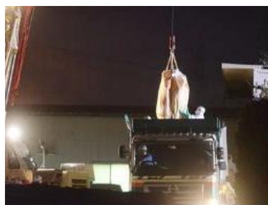
クレーン作業時の安全確認補助（フレコンバッグの積込みはクレーンで実施）
