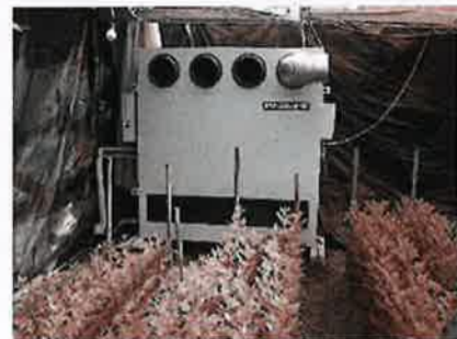
ヒートポンプ
