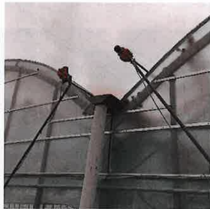
自動谷換気装置
