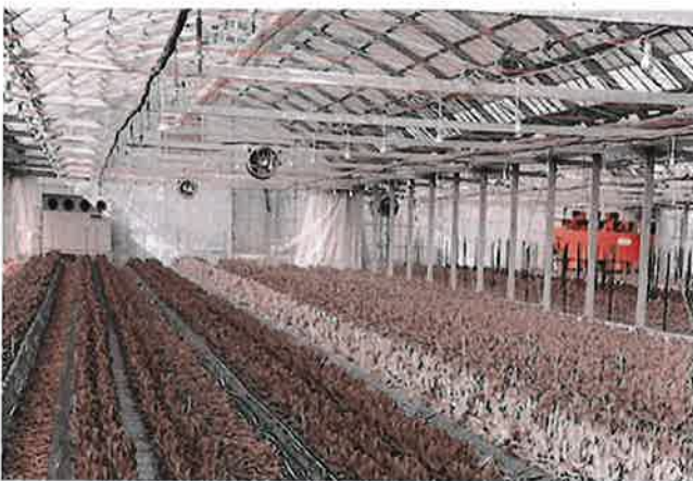
ヒートポンプと暖房機の併用状況
