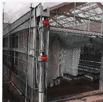
自動側換気装置
