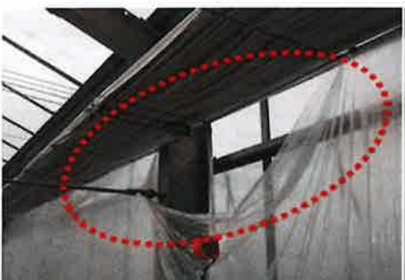
肩部の垂れ下がりによる隙間
