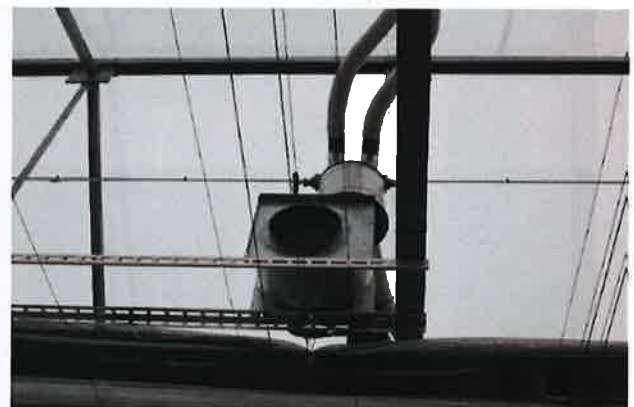
空気膜の加圧のための送風ファン
