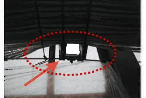
肩部の滑車付近の隙間
