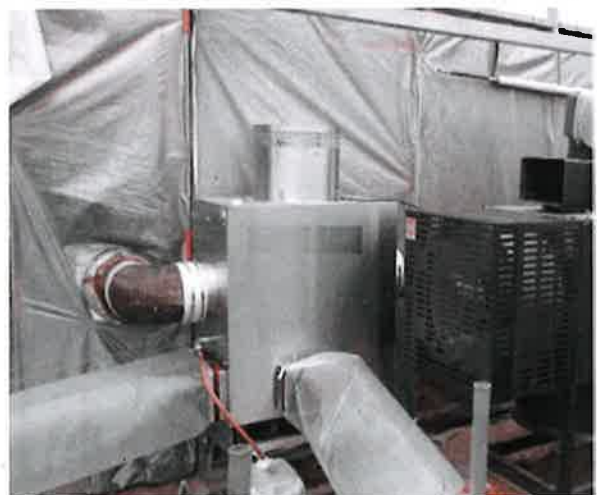
排熱回収装置
