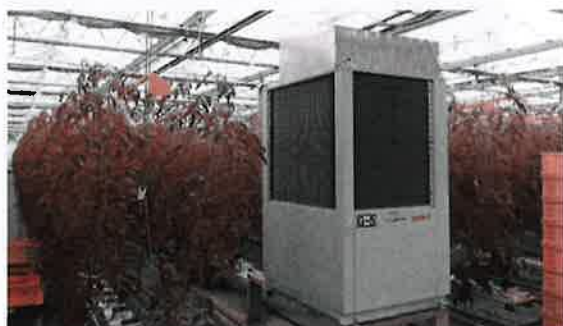
地下水熱源ヒートポンプ (室内機)
