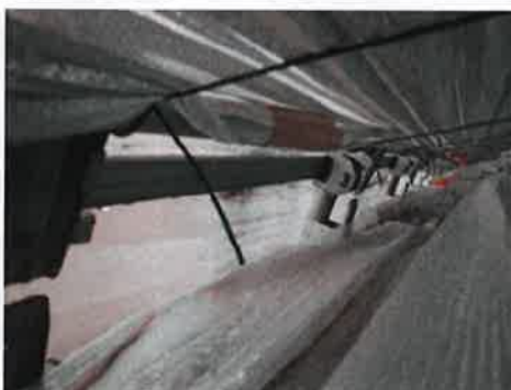
多層カーテン肩部の隙間
