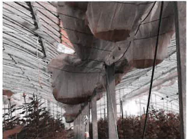
金魚鉢状に膨らんだ内張カーテン
