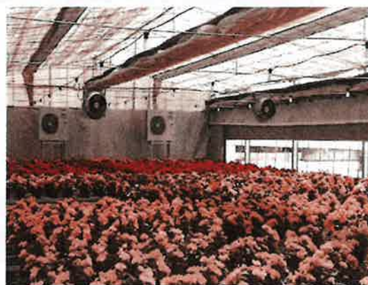
夜間冷房にも利用されるヒートポンプ
