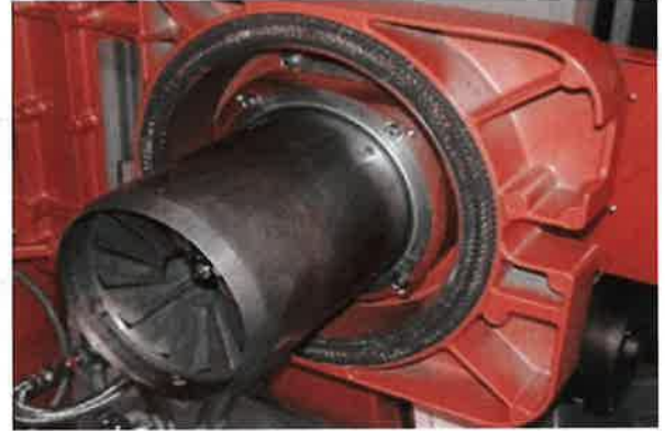
清掃後のエアコーン、ディフューザーの 状態
