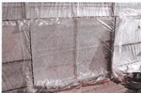
使用しない出入口を目張り
