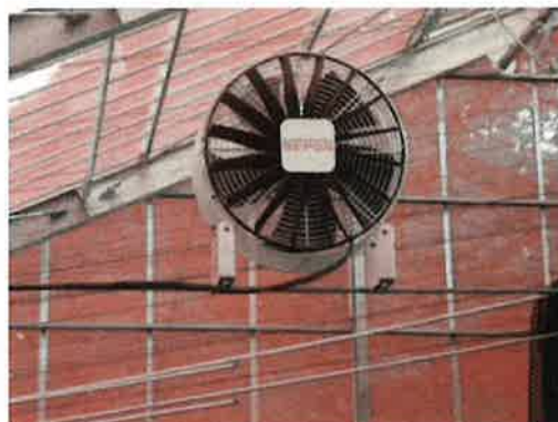
空気の流れをつくる循環扇
