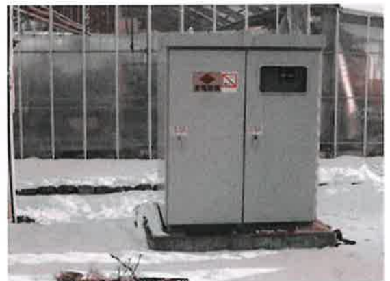
高圧受電設備(キュービクル)
