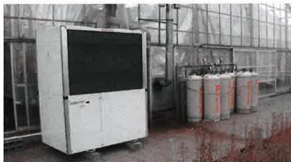
ガスヒートポンプ (室外機)
