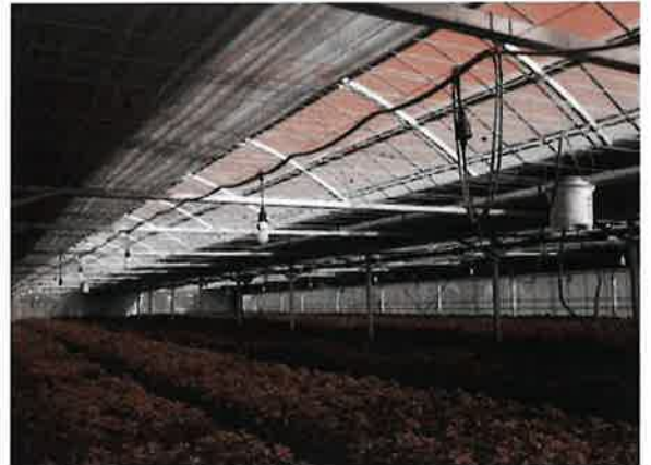
内張カーテンの自動開閉
