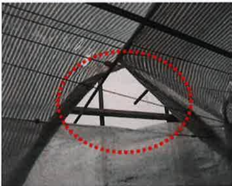
天井カーテンの隙間（妻面）
