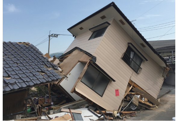
H28熊本地震により倒壊した住宅 (熊本県益城町) (平成28年4月長崎県被災建築物応急危険度判定チーム撮影)
