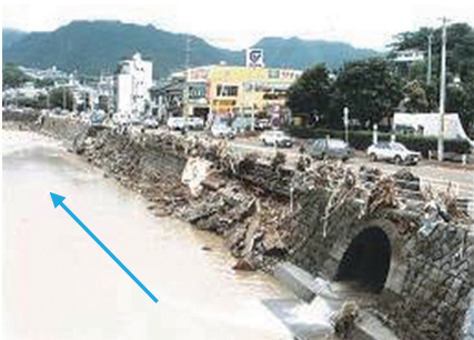
長崎大水害 (S57.7.23) の被災状況
