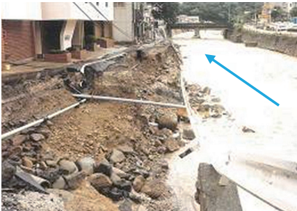
長崎大水害 (S57.7.23) の被災状況
