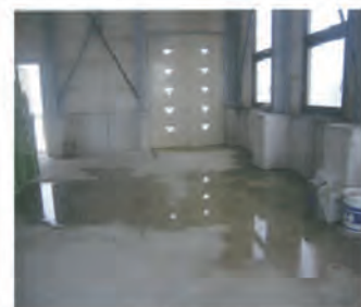
排水門開閉操作室 (室内への雨漏り)
