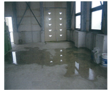
排水門開閉操作室 (室内への雨漏り)
