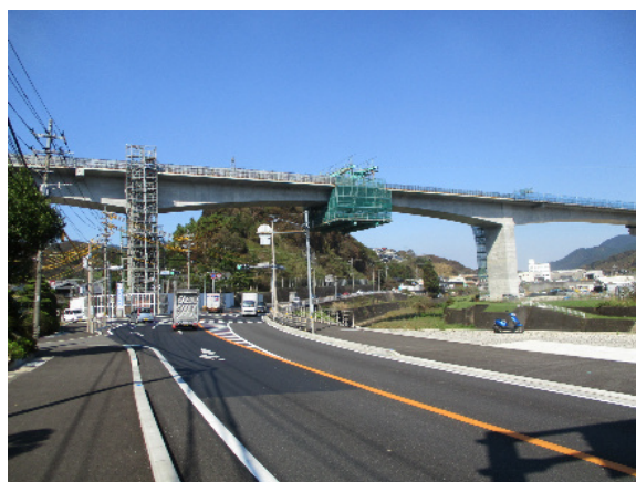
④写真左側の橋脚からの張り出しも完了し、 橋げたが繋がりました (令和元年 10 月撮影)
