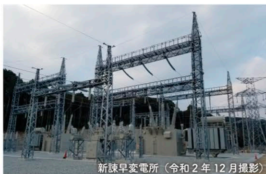
新諫早変電所（令和2年12月撮影）
