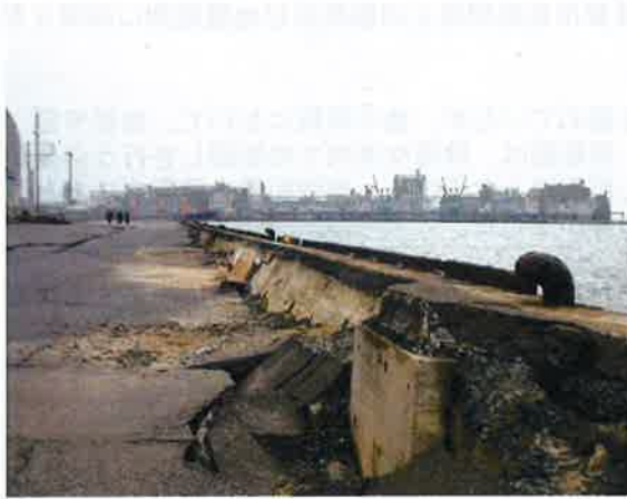
大規模地震被災状況（写真 福岡西方沖地震：博多港）
