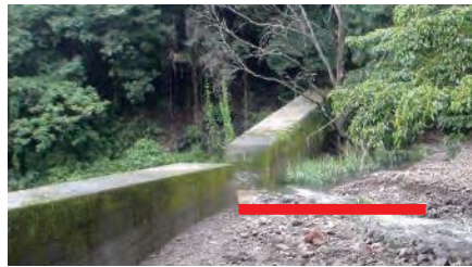
令和2年7月豪雨後 赤線の高さまで土砂が堆積し、 下流への被害を軽減
