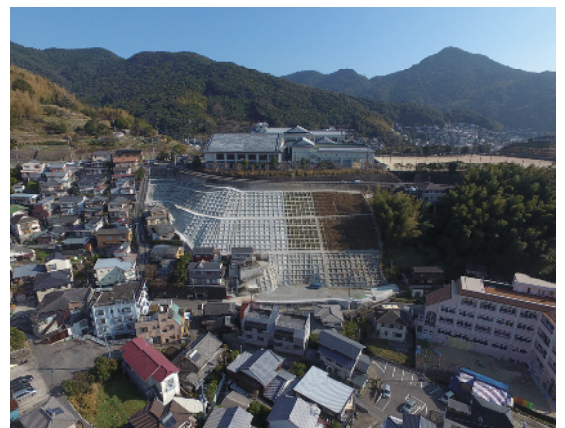
斜面下部の多くの人家を保全している法面工（長崎市）
