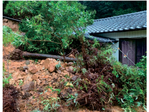
人家隣接の斜面が崩落（令和元年 佐世保市）
