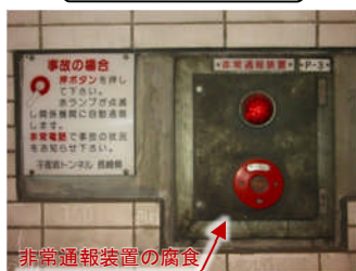
非常通報装置の腐食【判定区分:Ⅱ】
