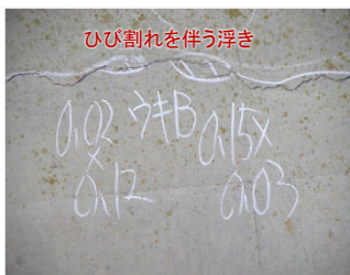
覆工アーチ部のひび割れを伴う浮き【判定区分:Ⅲ】
