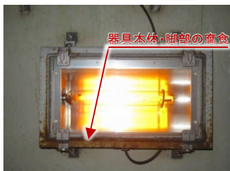
照明器具の腐食【判定区分:Ⅱ】
