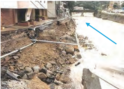
長崎大水害（S57.7.23）の被災状況
