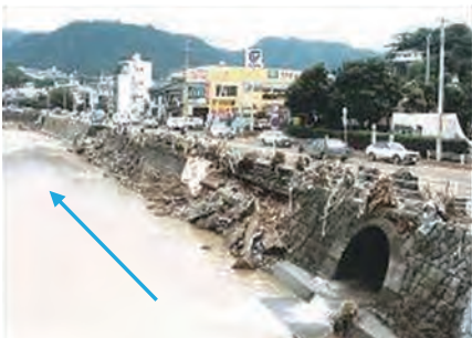
長崎大水害（S57.7.23）の被災状況
