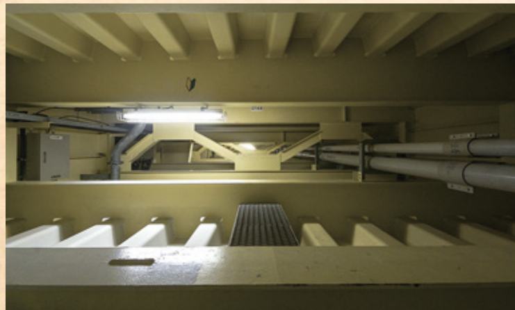
橋の内部。大島大橋は水道や電話線などのインフラも通っている。
