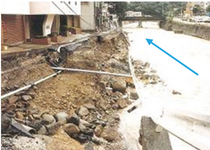
長崎大水害 (S57.7.23) の被災状況
