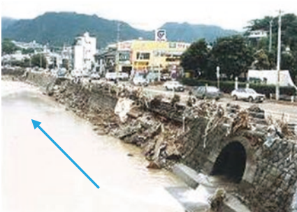
長崎大水害 (S57.7.23) の被災状況
