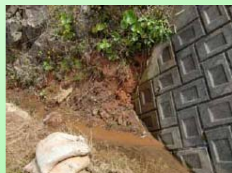
（外堤側の漏水孔）
