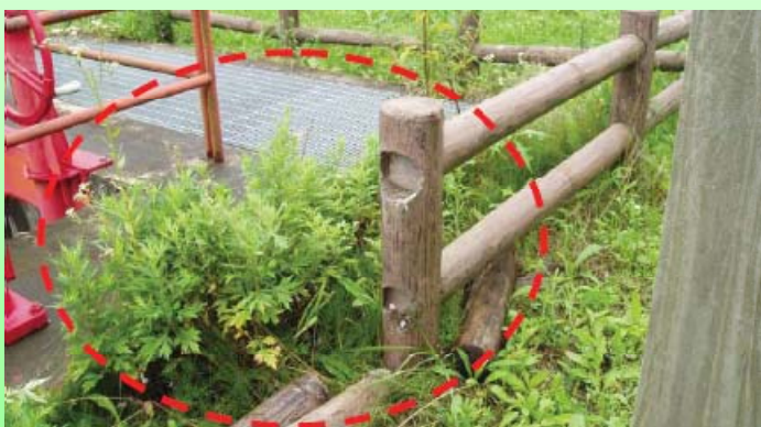
・安全施設の損傷を確認
