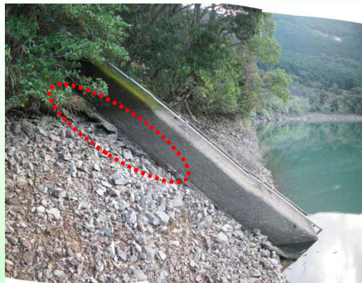
⑥斜樋底部の陥没
