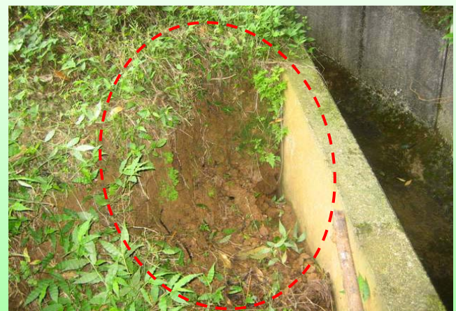
・堤体とコンクリート構造物との接合部で隙間、陥没の有無を確認
