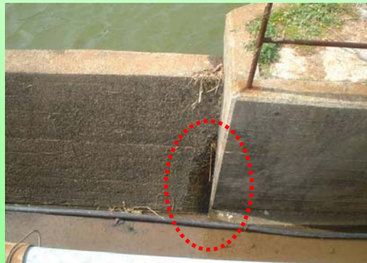
⑧継目、亀裂からの漏水(水路壁の変色)
