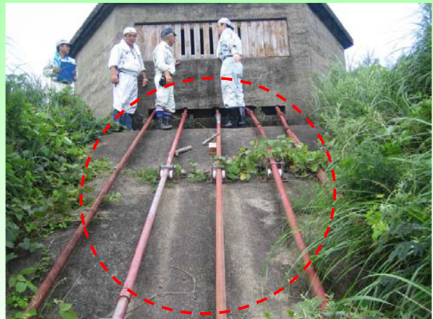
・取水施設の劣化(錆び)を確認
