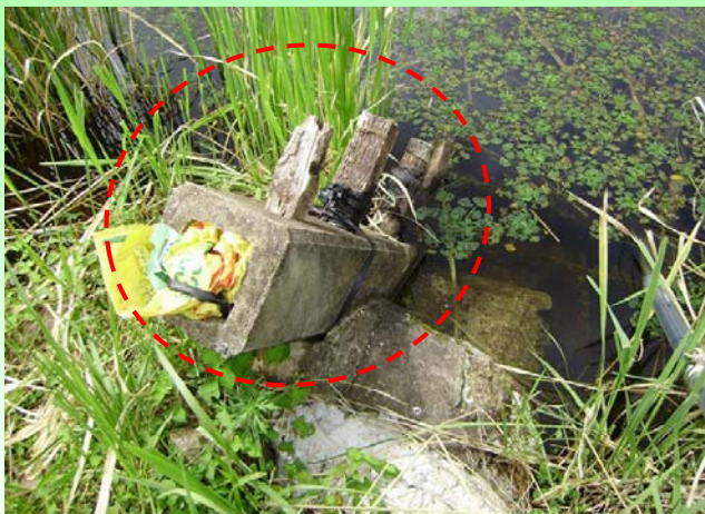
・取水施設の劣化(腐食)を確認
