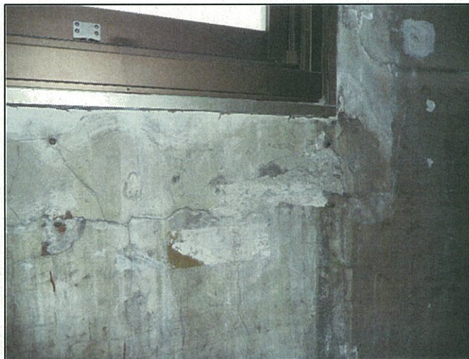
(EV機械室)『壁ひび割れ』
