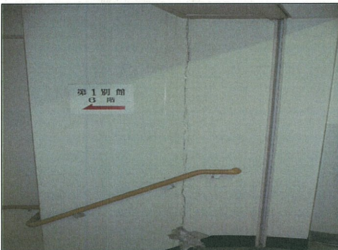
④ 6階(渡り廊下)『老朽化』
