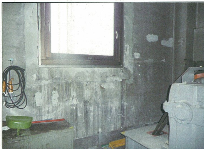
② (EV機械室)『壁ひび割れ』
