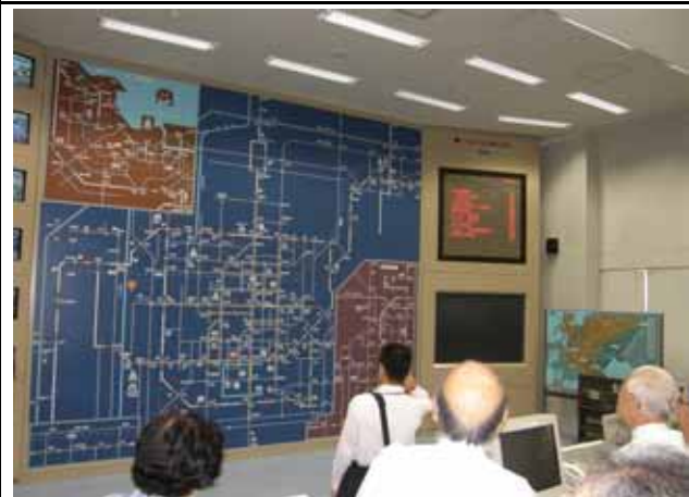
交通管制室(警察本部)
