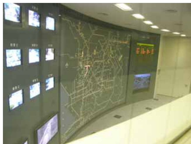
交通管制センター（警察本部）
