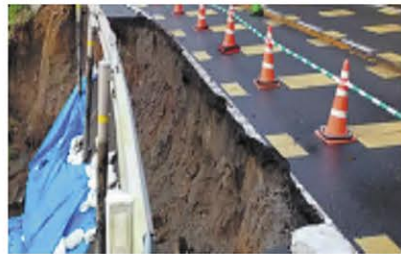
国道57号被災(片側交互通行規制)
