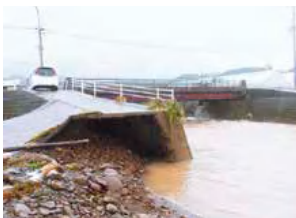
令和2年7月豪雨により被災した佐奈河内川(大村市今富町)
