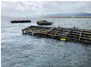
令和2年台風10号により被災した長崎空港連絡船橋施設(大村市箕島町)
