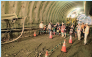
仮設備や実際に重機が動くところを見学しながらトンネルの一番奥の掘削しているところまで行きました。
