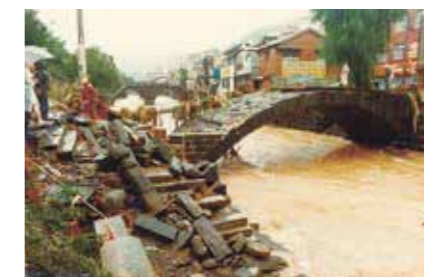
長崎大水害時の被災状況 【中島川袋橋】
