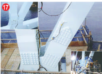
17 工事名 主要地方道平戸生月線道路災害防除工事(生月大橋本復旧) 施工者 大島・三菱JV 技術者 元川 貴文 工事内容 橋を使いながら修理する工事です。
