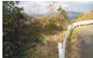
老朽化したガードレール
