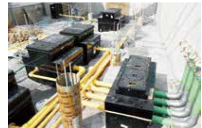
油配管（ガソリンスタンド）
