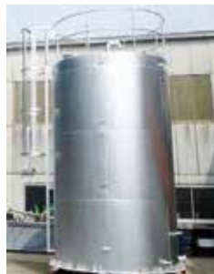
30KL地上油タンク
