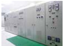
受変電盤製作・施工
