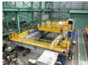
天井クレーン
