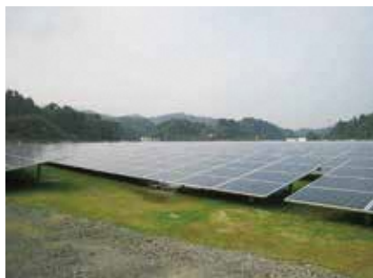
太陽光発電システム
