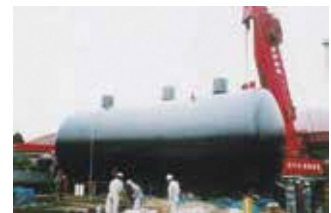
160KL地下タンク
