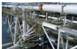
配管支持金物
