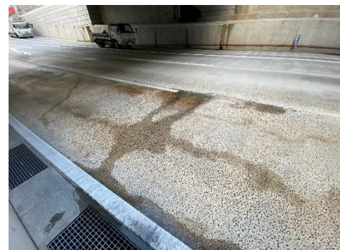
写真－2 漏水箇所③
