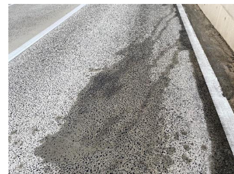
写真－3 漏水箇所⑤
