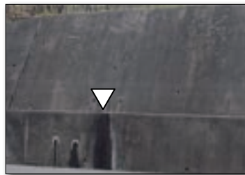
地下水の流出
