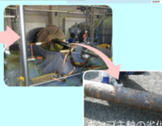
ポンプ主軸の劣化
