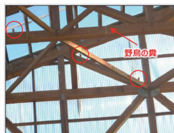
▲ 堆肥舎内のスズメ・糞
