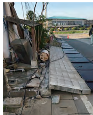
熊本地震での被災事例
