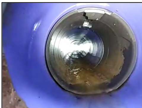
【オンライン検査（管の通り確認）】
